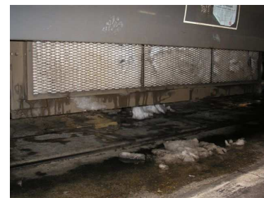
Convertisseur du système de chauffage rempli de neige
